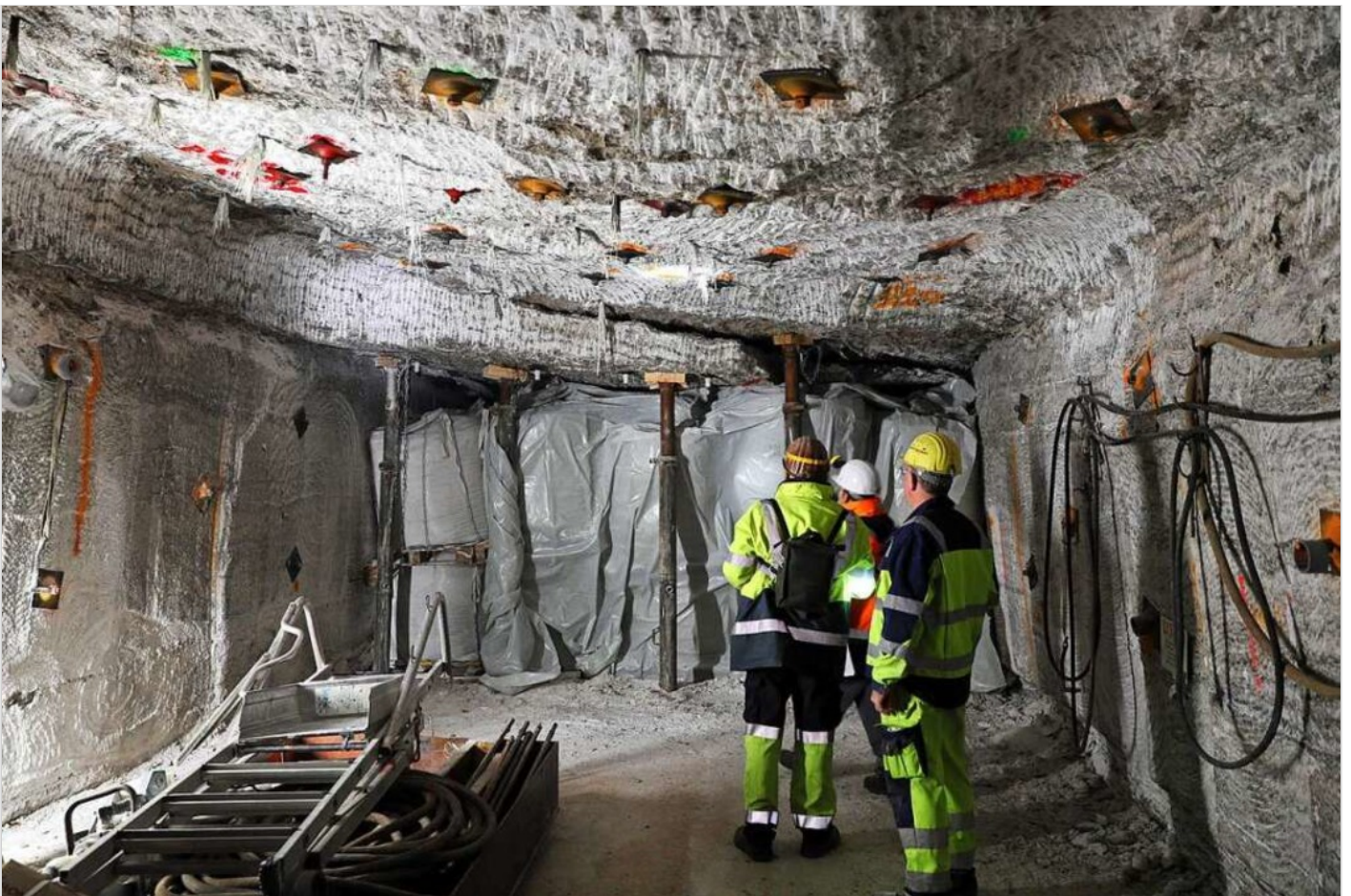
Inspektion am Dach eines rissigen Stollens auf der Enddeponie der Stocamine in einem ehemaligen Kalibergwerk (Foto stammt aus dem Jahr 2017) Foto: Thierry GACHON
